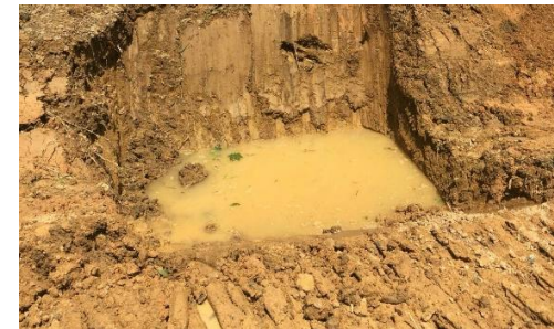
บ่อดักตะกอนชั่วคราว
